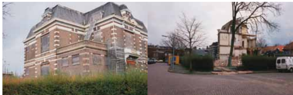
De villa dichtgetimmerd en tijdens de sloop (gefotografeerd door de heer M. van de Dool)
